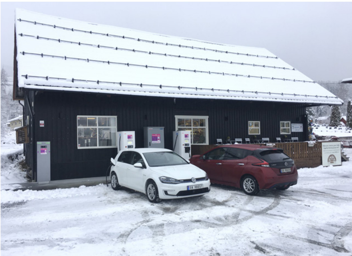
Hurtigladestasjon montert utenfor Trollbua i Eggedal, foto: Trond Lindseth
