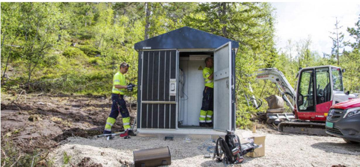
Jon Hvidsten og Vidar Brenna er snart klar for å idriftsette ny trafo på Bonkliåsen i Eggedal, foto: Trond Lindseth
