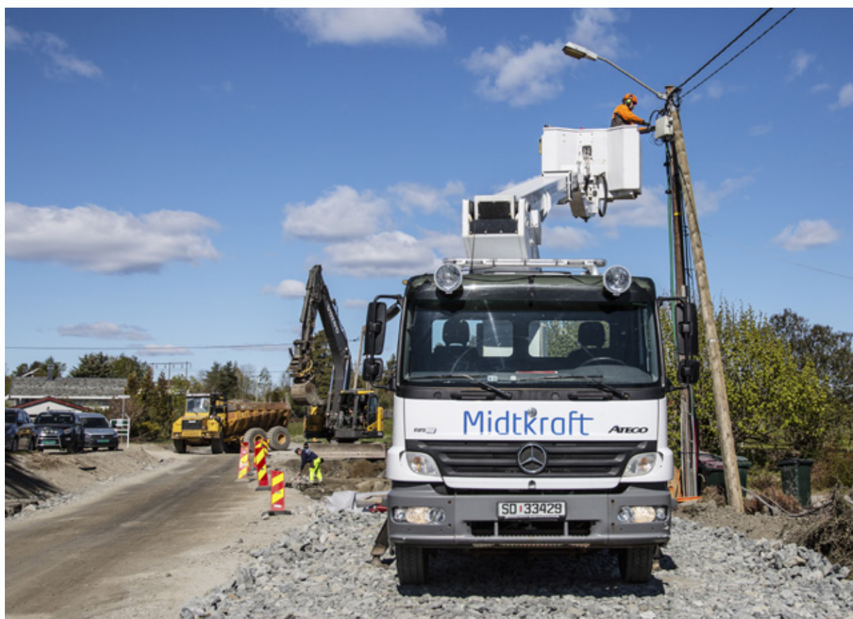
Stor ombygging av lavspentnettet ved Badeveien, i kurvbilen Truls Eivind Skretteberg, foto: Trond Lindseth
