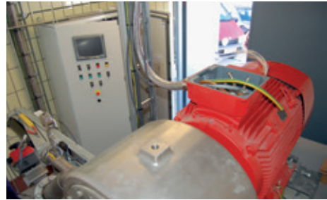
Det er ikke stor plass inne i Sønsteby kraftstasjon
