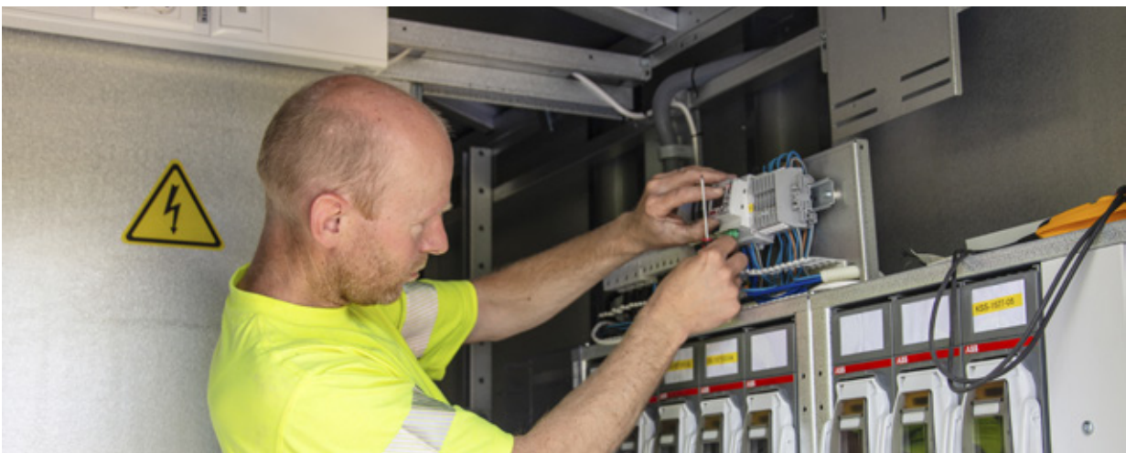
Vidar Brenna monterer innsamlingsutstyr for nye målere i ny trafo på Bonkliåsen i Eggedal, foto: Trond Lindseth
