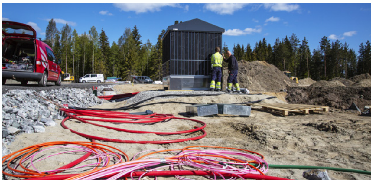
Det blir mye rør for kabel/fiber i det nye boligfeltet på Haraldsrudmoen. Marwin Grøterud og Vidar Skjellhaugen monterer kabelskap, foto: Trond Lindseth
