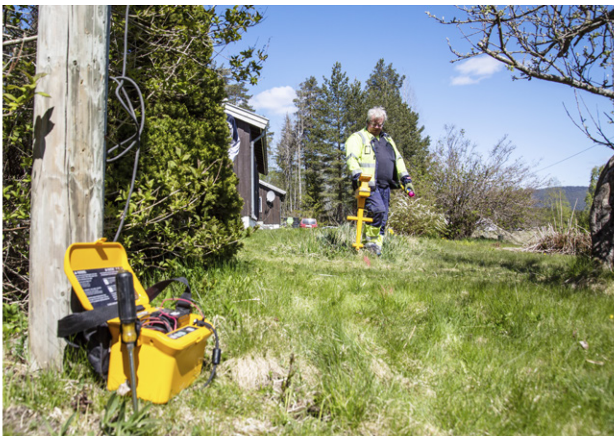
Svein Ivar Gislegård peiler før graving av fiber inn til bolig i Sigdal, foto: Trond Lindseth
