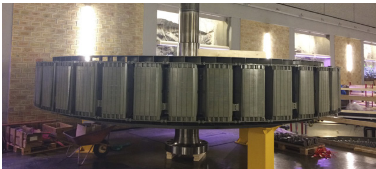
Store dimensjoner på rotor, aggregat 2 på Ramfoss Kraftverk. Foto: Odd Røvang
