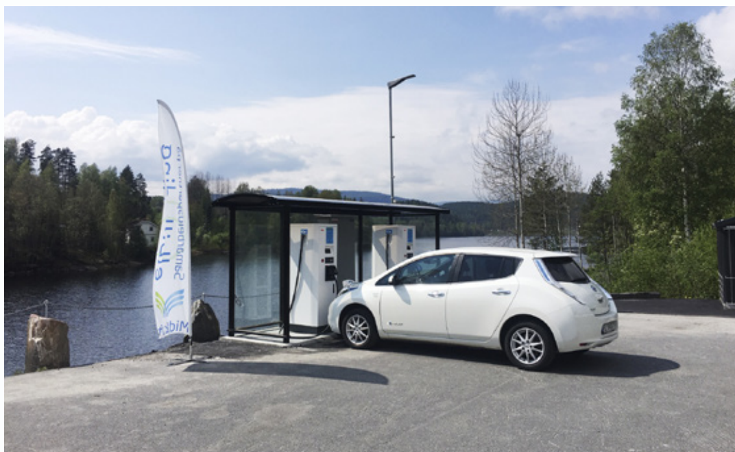
Hurtigladdestasjon i Prestfoss. Foto: Trond Lindseth
