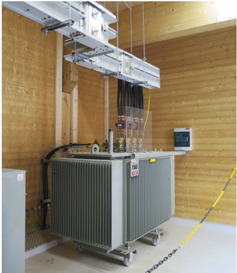
Norges første trafostasjon i massivtre hos Splitkon i Åmot. Foto: Trond Lindseth
