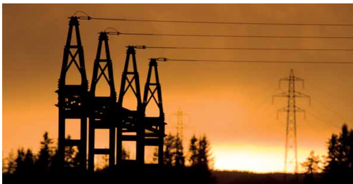
Høyspentmaster på Hovde trafostasjon, foto Erik Thalerud.
